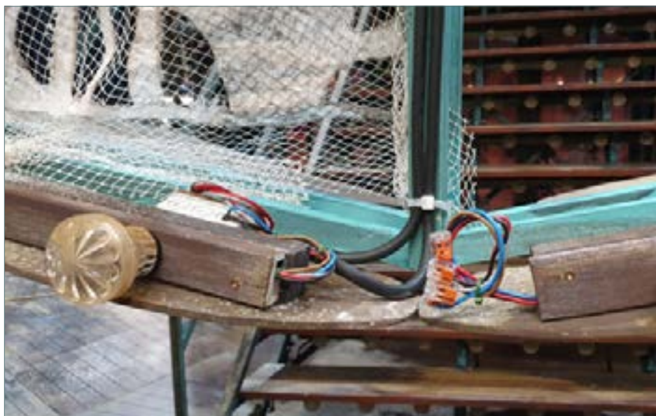
Für ein besseres Dimmverhalten wurden – statt einer LED-Beleuchtung – insgesamt 1000 Stück E14 Glühlampen am Karussell verbaut. Foto: Iris Abel
